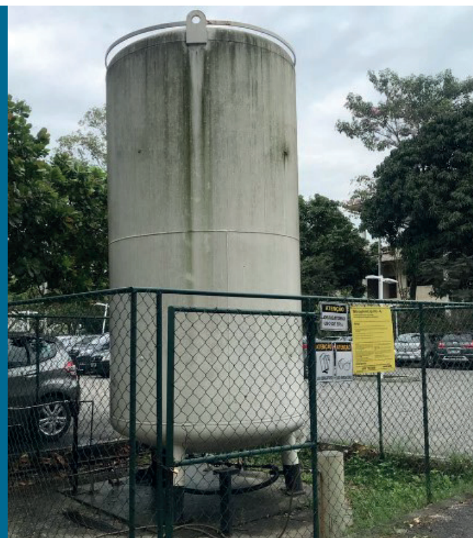
Figura 1 - Tanque de nitrogênio líquido localizado no estacionamento do Bloco G
